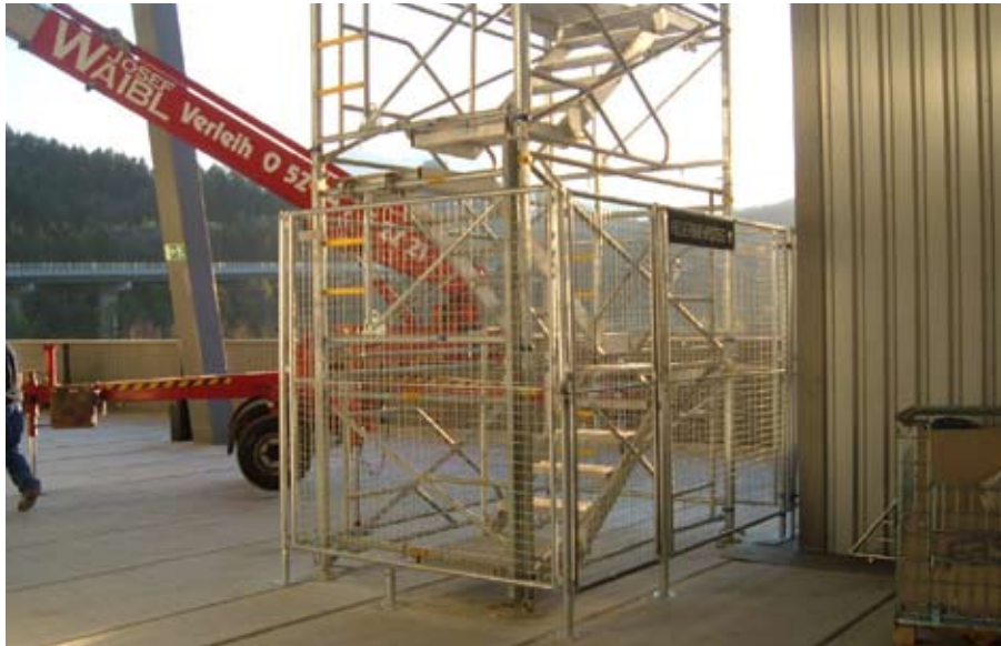
Die Arbeiten im Innsbrucker Tivoli-Neu werden bald abgeschlossen sein. Alle Bilder: rentES mobile Sicherheitstechnik
